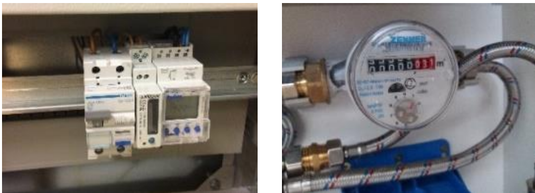
Abbildung 19: Strom- und Wasserzähler
