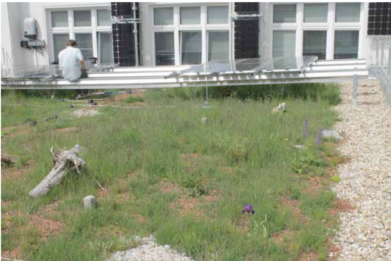
Abb. 44: Dach- und Fassadenbegrünung in Kombination mit Photovoltaikpaneelen auf dem Schuldach.
